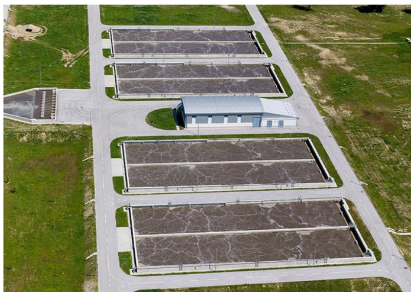
Slika 2.11. Biološki dio pročišćavanja na CUPOVZ.
