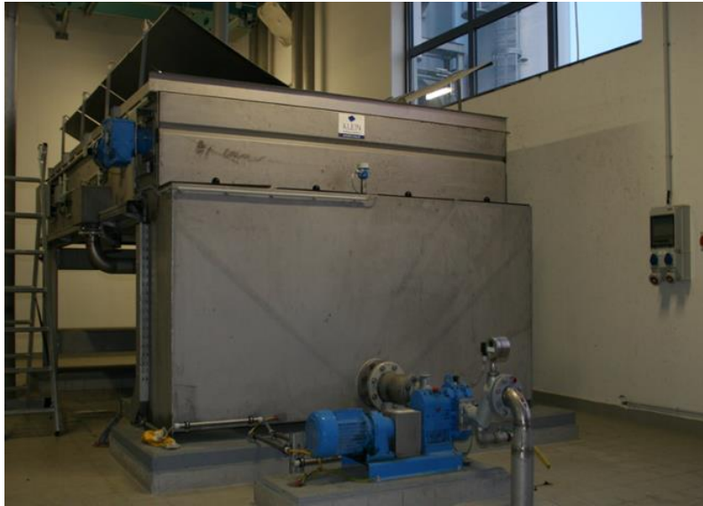
Slika 2.14. Trakasti zgušnjivač na CUPOVZ.
