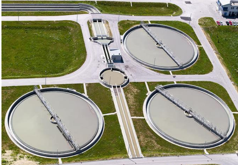
Slika 2.10. Prethodni taložnici na CUPOVZ.
