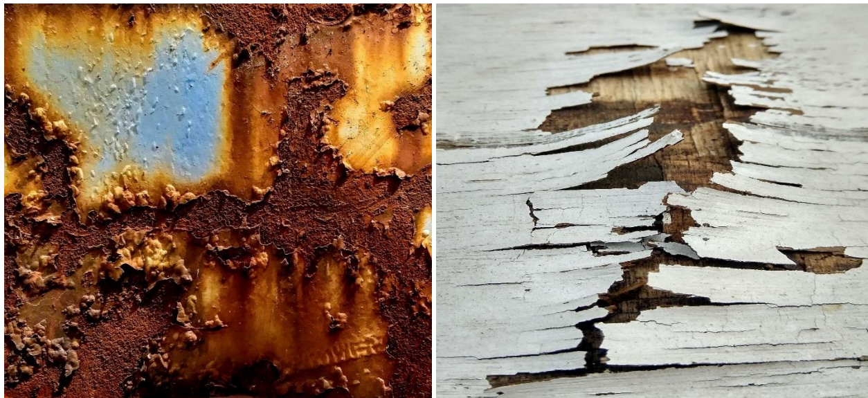
Slika 1. Primjer korozije metala i drvenih materijala
