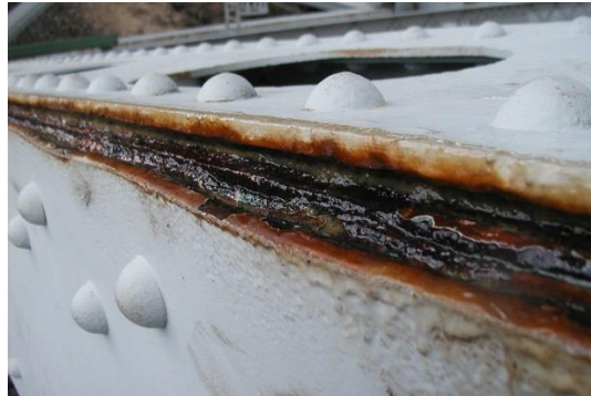
Slika 4. Prikaz korozije u procijepu između dviju spojenih površina čeličnog mosta [8]
