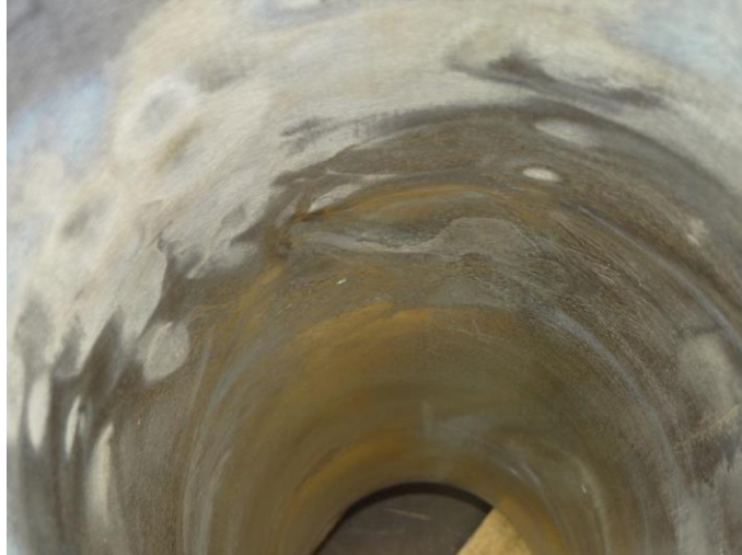
Slika 22. Unutarnja strana plašta reaktora s korozijom stijenke
