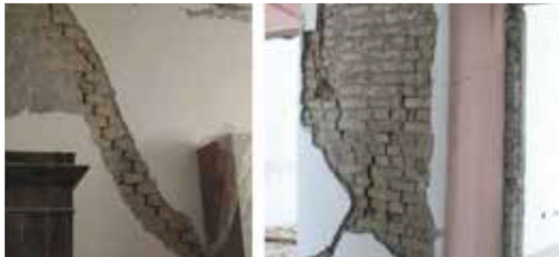
Slika 29. Pukotine na nosivim zidovima [28]
