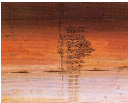
Slika 2. Primjer izražene rupičaste korozije uzrokovan izostankom katodne zaštite[12]
