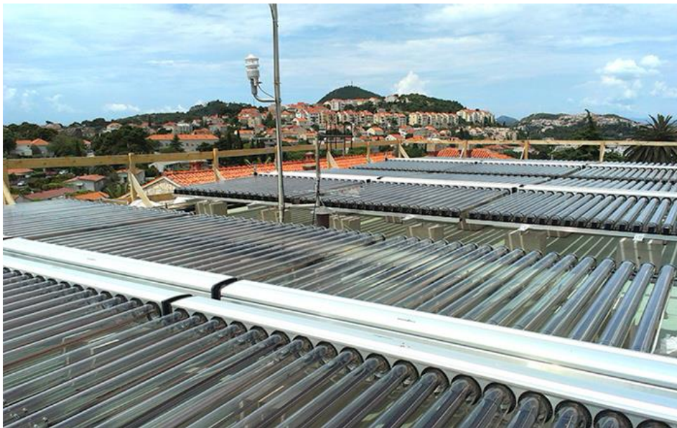
Slika 9. Polje solarnih vakuumskih kolektora na krovu objekta [16]
