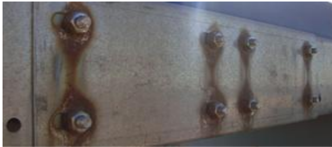
Slika 2. Galvanska (kontaktne) korozija [4]
