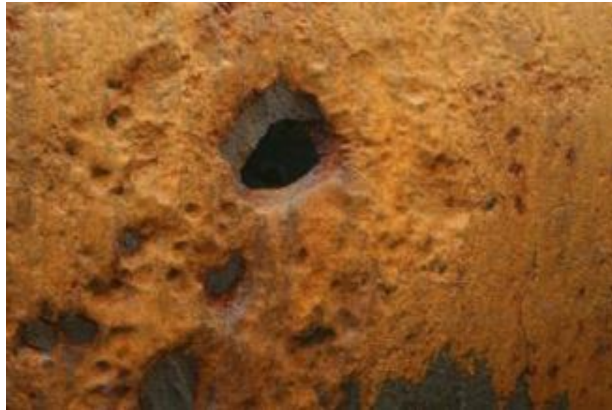
Slika 2. Primjer jamičaste korozije cijevi[12]
