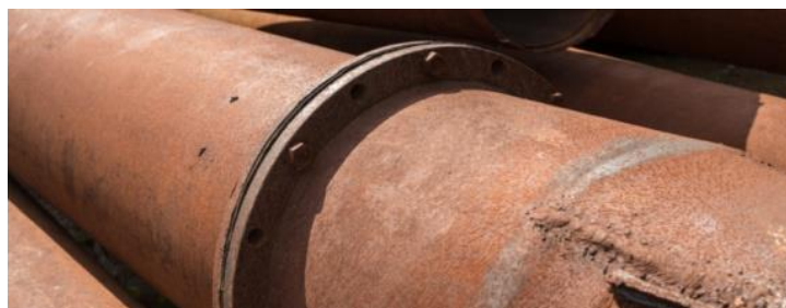
Slika 1. Primjer jednolike korozije cijevi[10]
