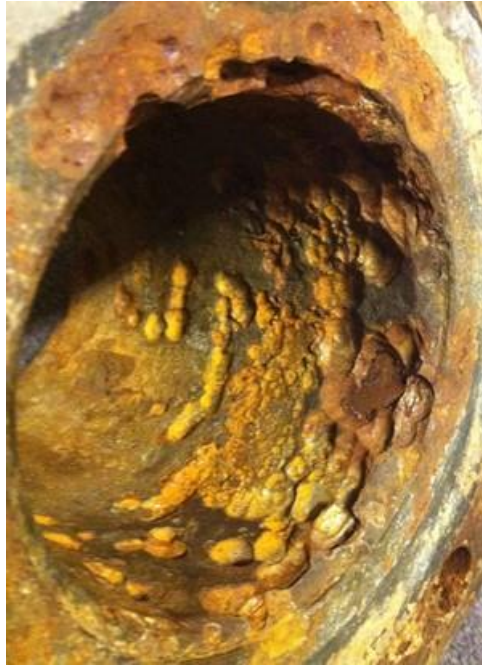
Slika 5. Primjer korozije cijevi pod mikrobiološkim utjecajem[14]
