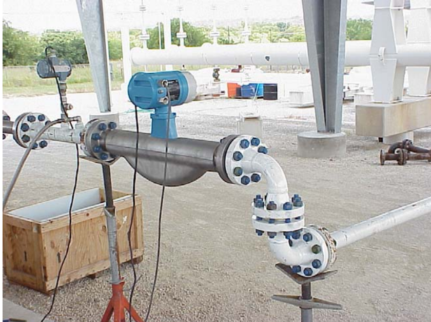
Slika 18. Instalacija Coriolisova mjerila protoka u pogonu
