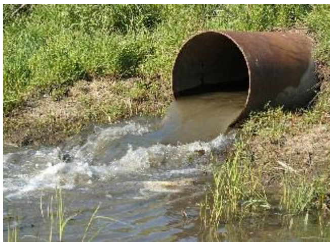
Slika 2.1. Komunalna otpadna voda
