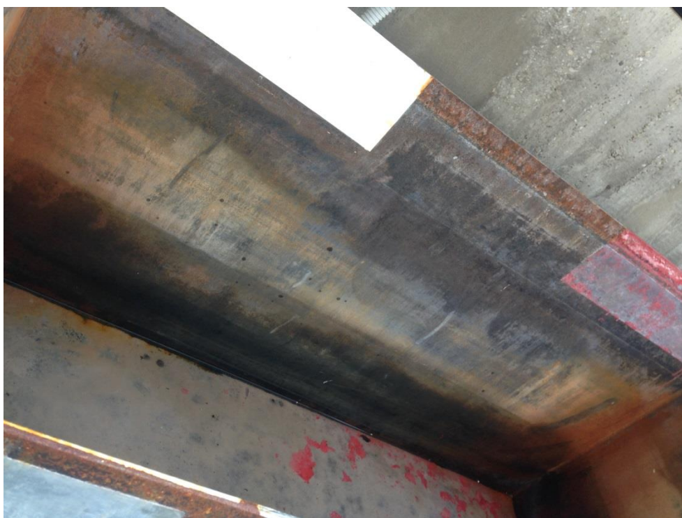
Slika 3-1. Prazan ispitni bazen s vidljivim antikorozivnim premazima i korodiranim dijelovima
