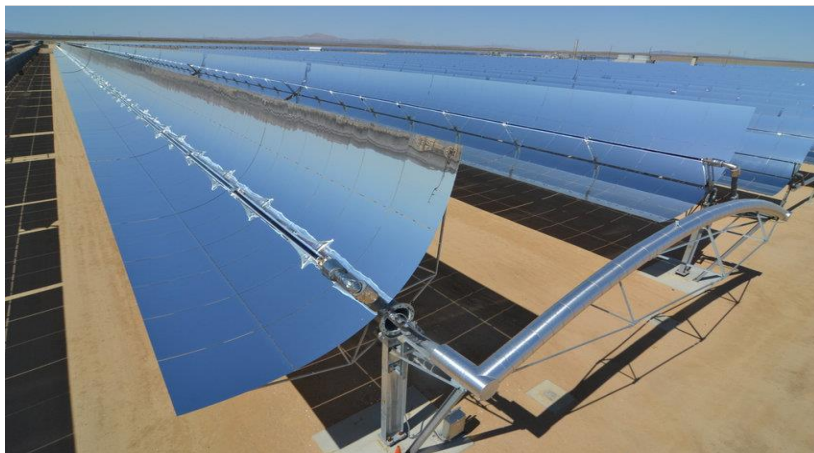
Slika 5. Flagsol Heliotrough kolektor [7].
