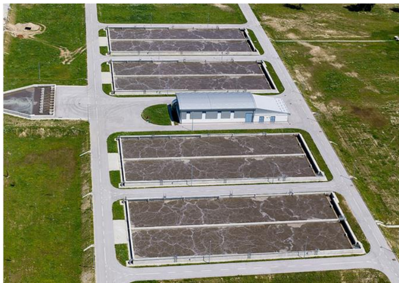
Slika 2.11. Biološki dio pročišćavanja na CUPOVZ.
