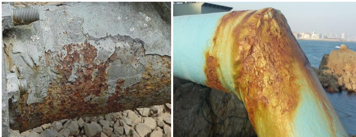
Slika 3. Primjer oštećenja uzrokovan atmosferskom korozijom
