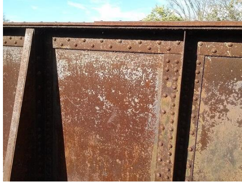
Slika 2. Prikaz jednolike korozije na površinski velikom elementu čeličnog mosta [6].
