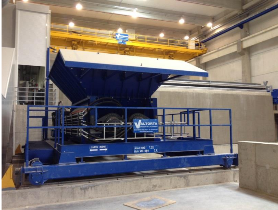
Slika 28. Prikaz primarnog usitjivača otpada
