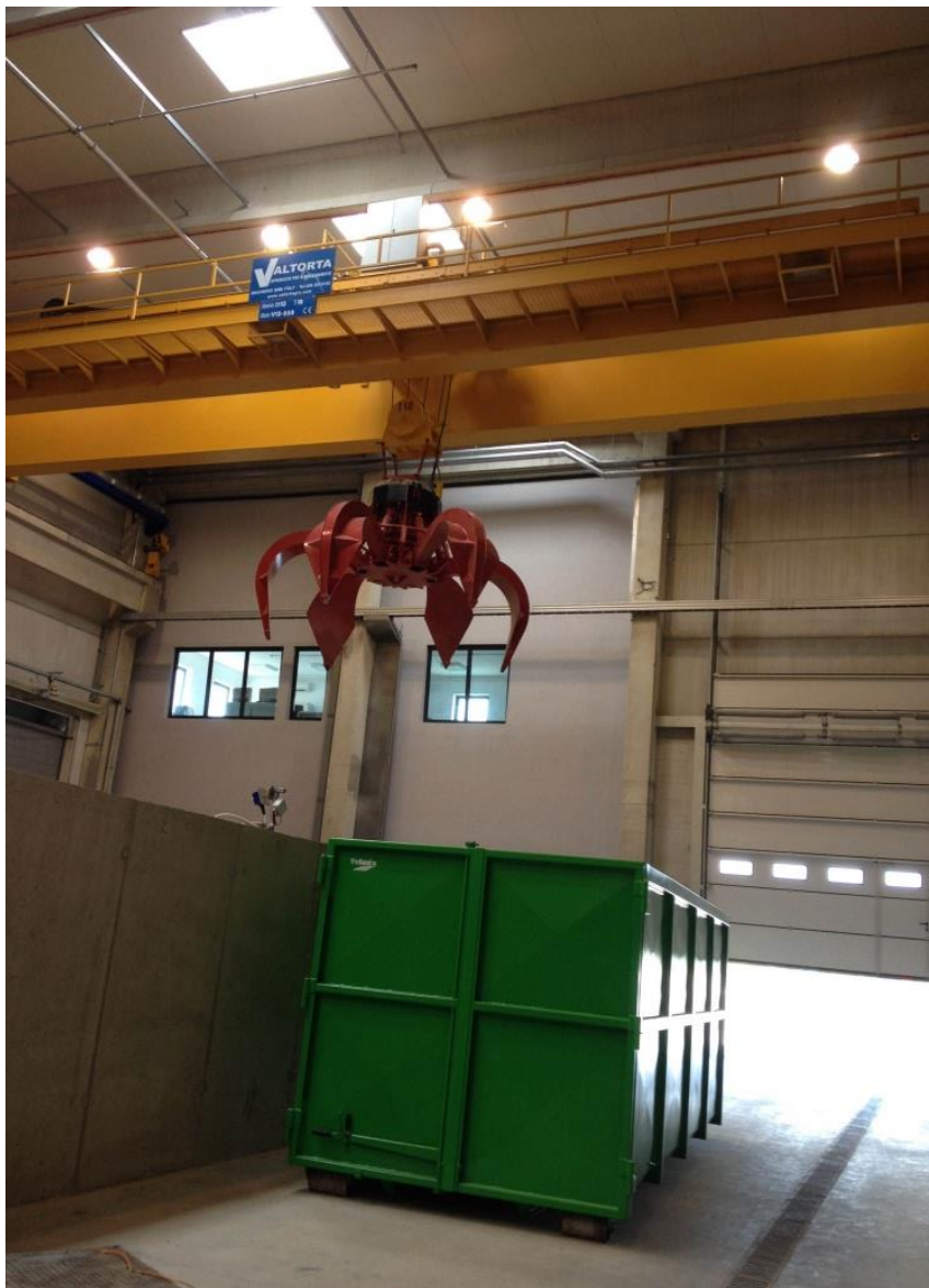
Slika 27. Prikaz automatski upravljano g kranu za prijenos otpada do dijela postrojenja za predobradu otpada
