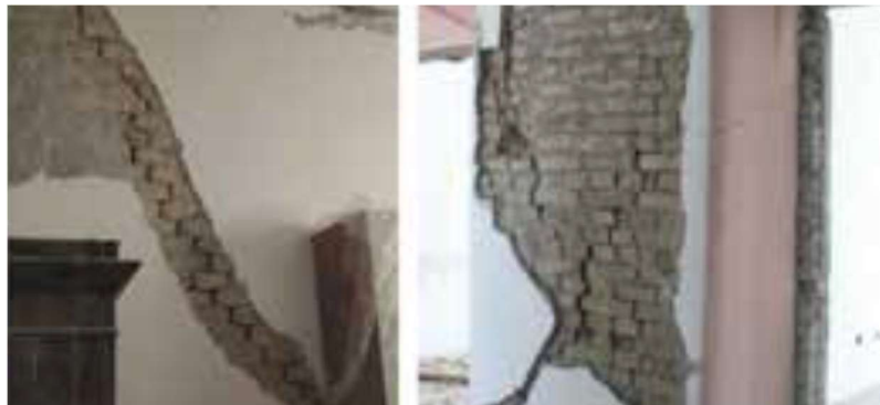
Slika 29. Pukotine na nosivim zidovima [28]
