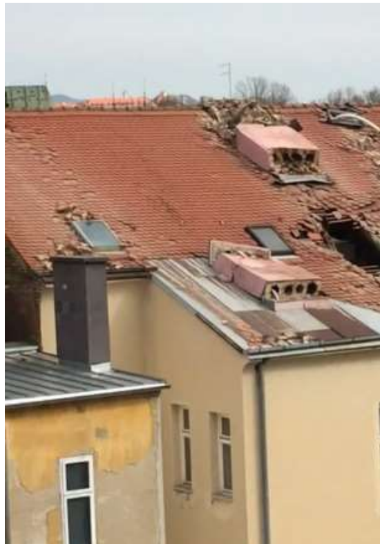
Slika 26. Primjer štete nastale urušavanjem dimnjaka [38]
