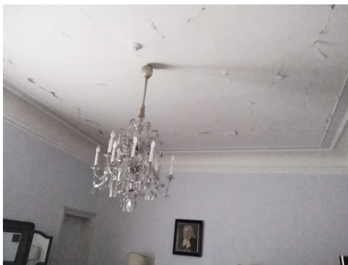
Slika 31. Oštećenja stropa u palači Pongratz [40]
