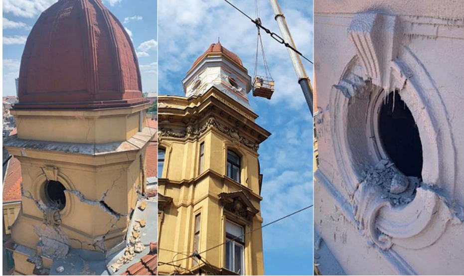
Slika 28. Kupola koja je uklonjena nakon potresa [39]
