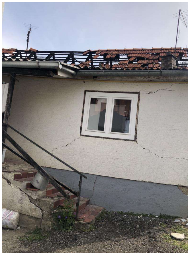
Slika 23. Primjer oštećenja u stubičkom kraju [35]
