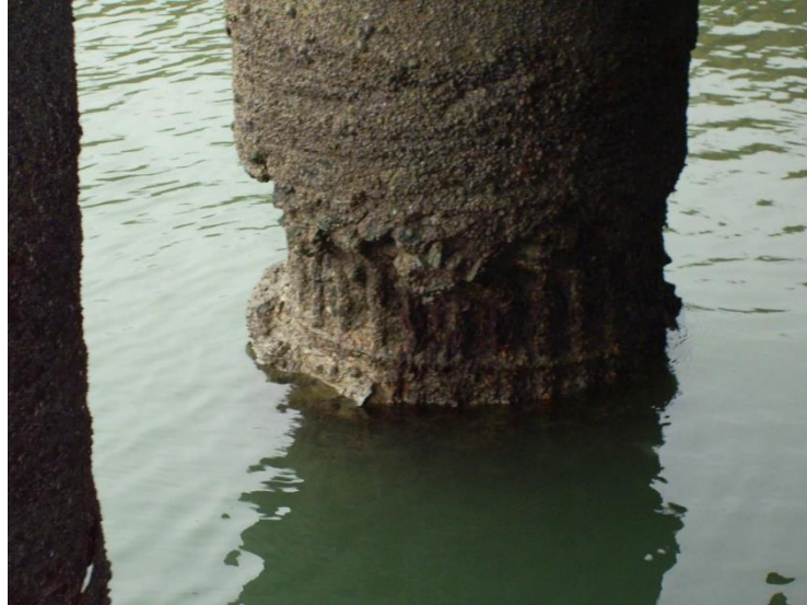
Slika 4. Primjer elektrokemijske korozije, uz vodenu liniju stupa [11]
