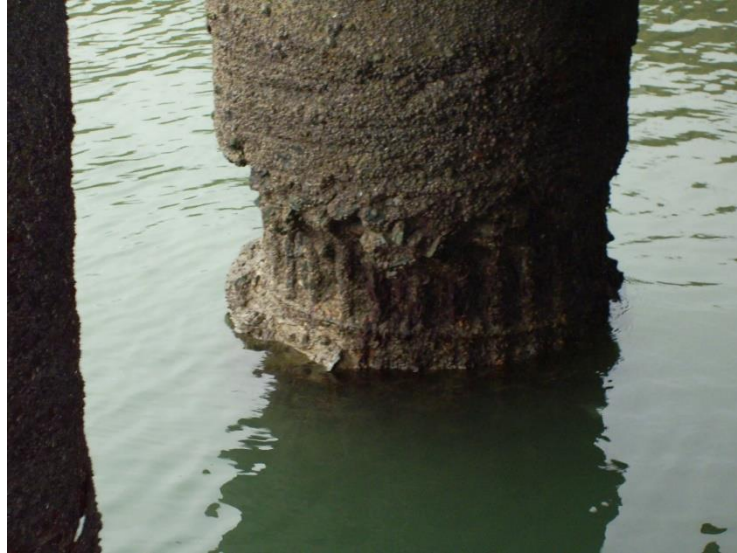
Slika 4. Primjer elektrokemijske korozije, uz vodenu liniju stupa [11]
