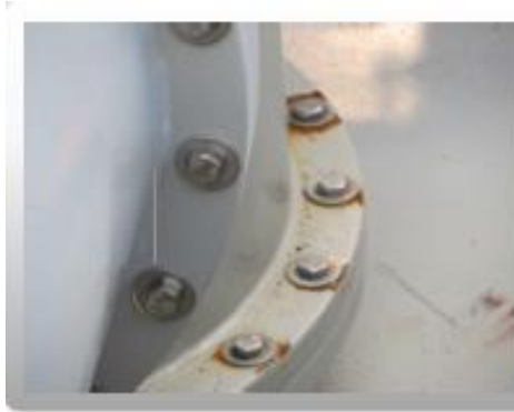
Slika 5. Prikaz pukotinske korozije [9]
