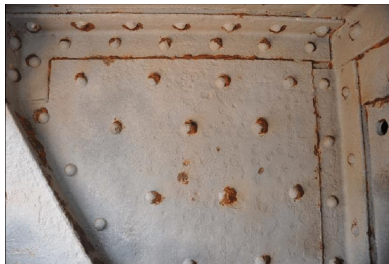
Slika 6. Pitting korozija na čeličnim pločama [12]
