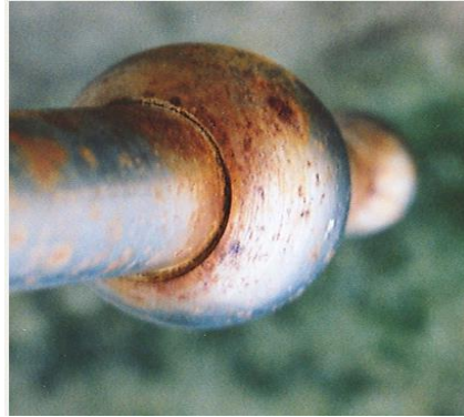
Slika 2. Korozija na cijevima [10]
