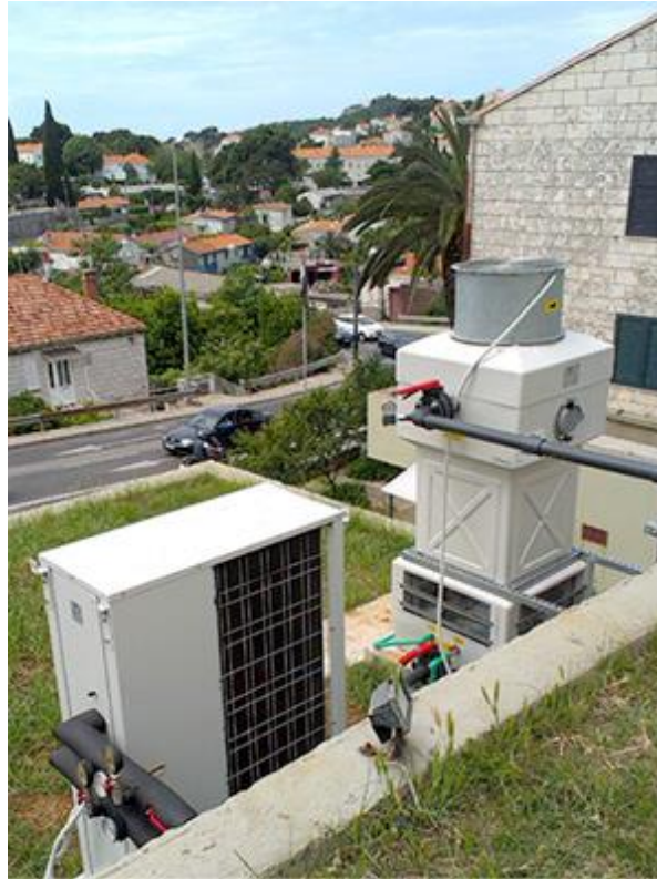
Slika 11. Kombinirani uređaj i mokri rashladni toranj učina 40.7 kW [16]
