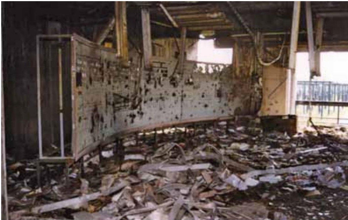
Slika 1.1. Ratno razaranje upravljačke prostorije TS 400/110 kV Ernestinovo, 1991. 4
