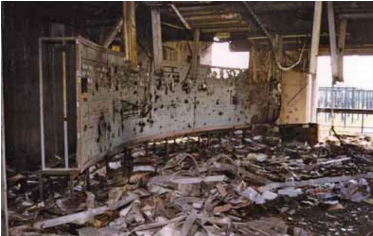
Slika 1.1. Ratno razaranje upravljačke prostorije TS 400/110 kV Ernestinovo, 1991. 4
