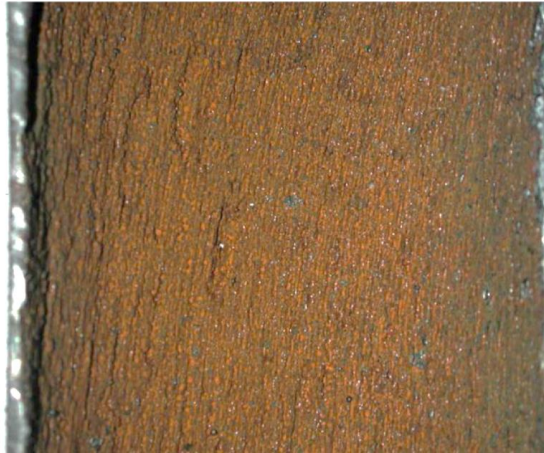
Slika 2.9. Primjer erozijske korozije unutar cijevi izrađene od ugljičnog čelika za skladištenje ukapljenog naftnog plina (uočava se karakteristična hrapava površina s nejednolikom debljinom) [2]
