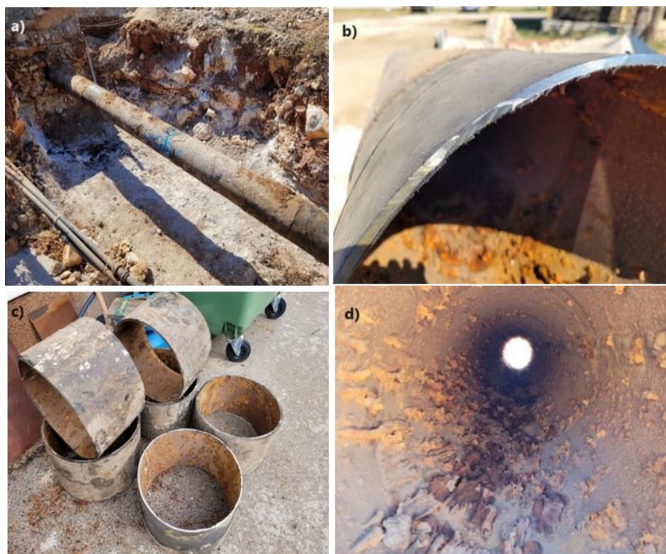
Slika 8. Vanjski izgled, a), b) i c) te unutrašnji izgled cijevi i d).
