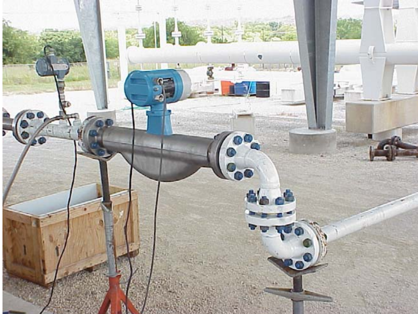
Slika 18. Instalacija Coriolisova mjerila protoka u pogonu
