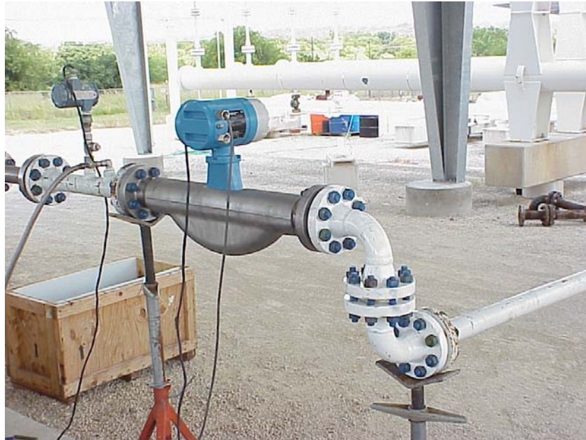
Slika 18. Instalacija Coriolisova mjerila protoka u pogonu
