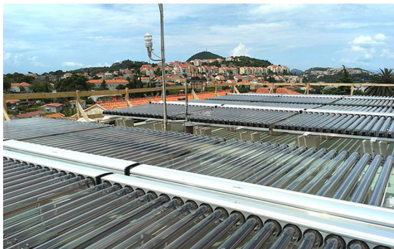
Slika 23. Polje solarnih vakuumskih kolektora površine 60 m 2 [40]
