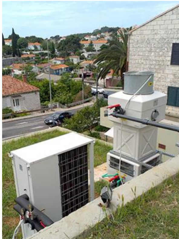
Slika 24. Dizalica topline i mokri rashladni toranj [41]
