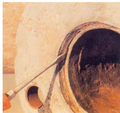
Slika 9. Korozija u cijevi izazvana morskom vodom [41].
