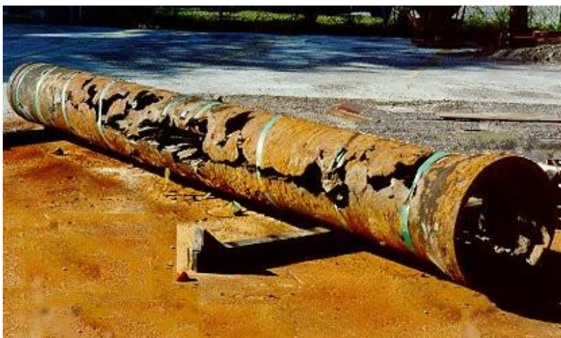
Slika 2.17. Utjecaj korozije na nezaštićenu cijev ( http://www.dontdig.com/plumbing/cast-iron-pipe-repair pristupio 15.5.2017)
