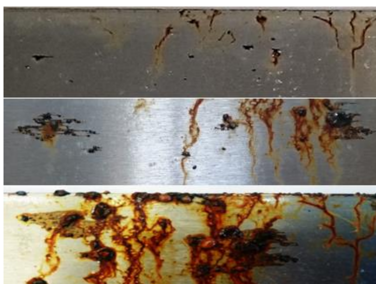
Slika 40. Napredak korozije na uzorku 6
