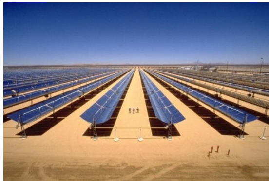
Slika 3. Parabolični kolektori u pustinji Mojave (California) [4]
