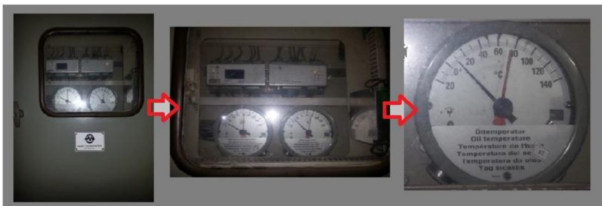
Slika 30. Mjerenje temperatura ulja transformatora 110/10 kV
