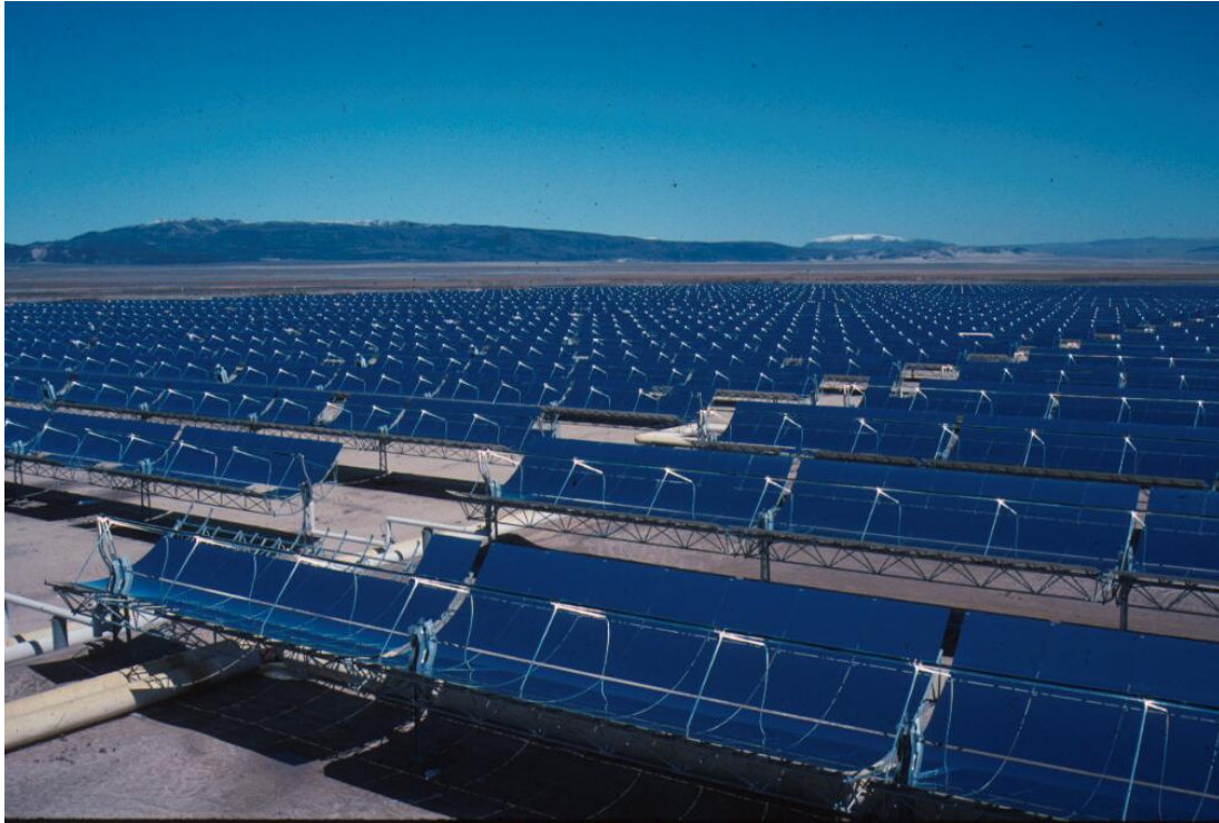
Slika 4. Parabolički kolektori u pustinji Mojave [6]
