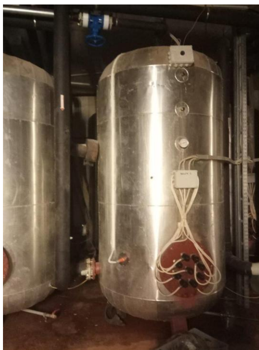
Slika 3-2: Bojler za toplu vodu
