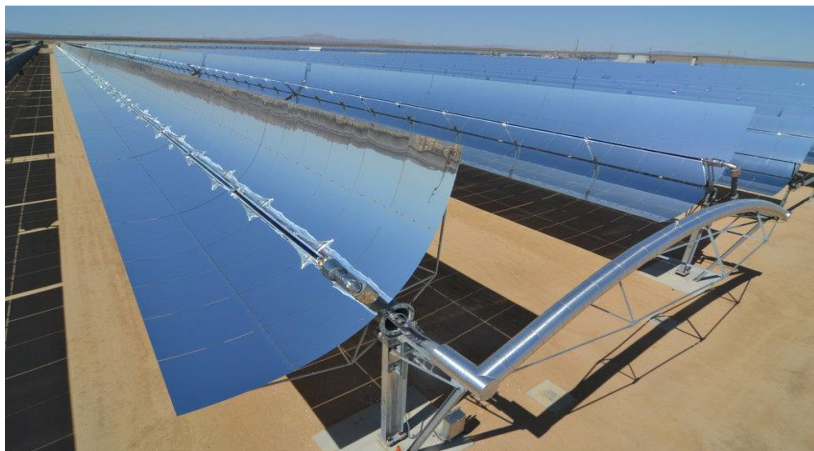
Slika 5. Flagsol Heliotrough kolektor [7].
