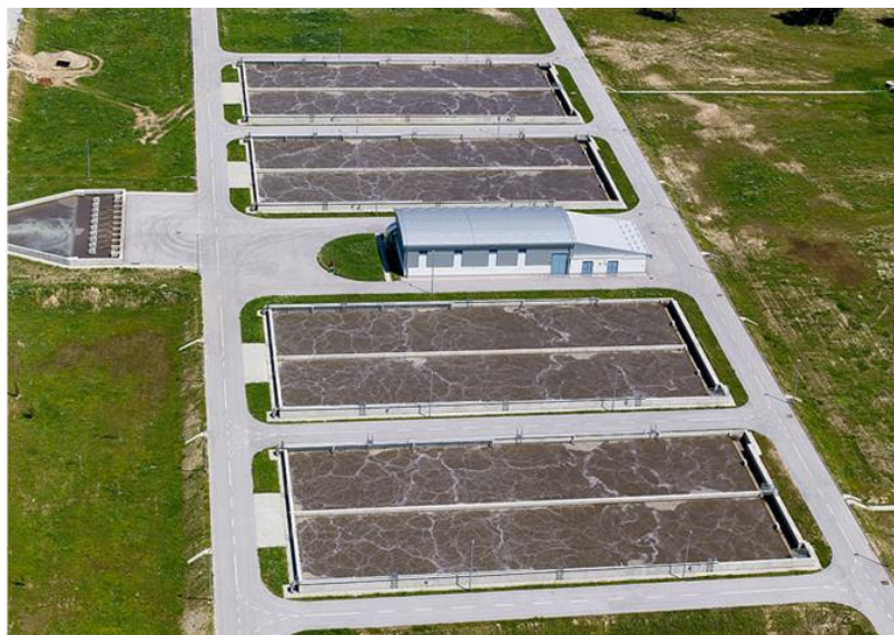
Slika 2.11. Biološki dio pročišćavanja na CUPOVZ.
