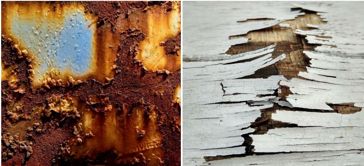
Slika 1. Primjer korozije metala i drvenih materijala
