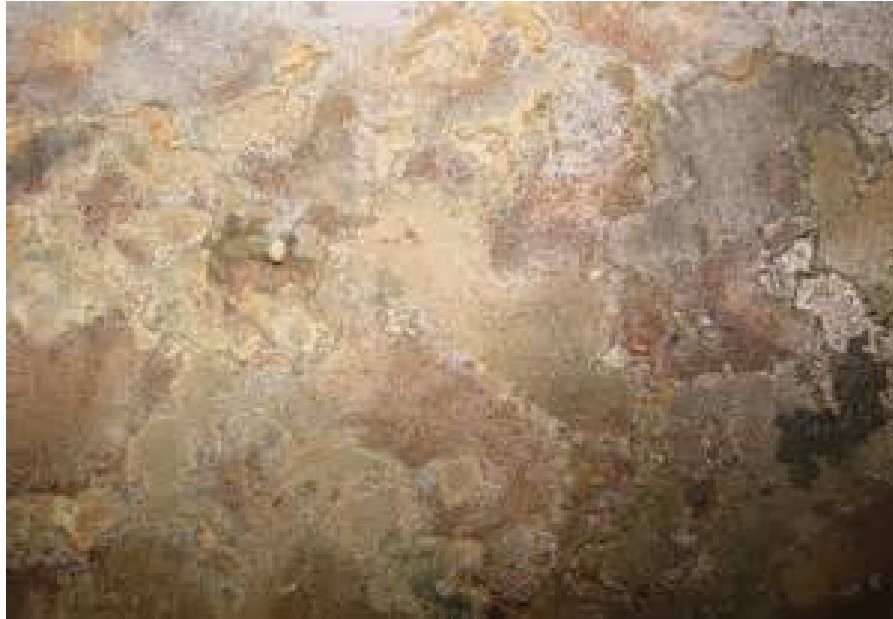
Slika 1. Izgled površine zahvaćene općom korozijom.
