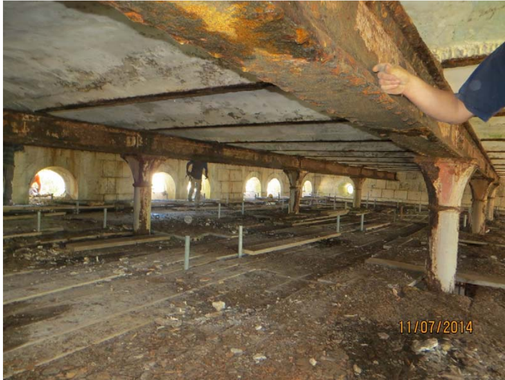
Slika 2. Primjer konstrukcije zahrdale u atmosferi s kloridima.
