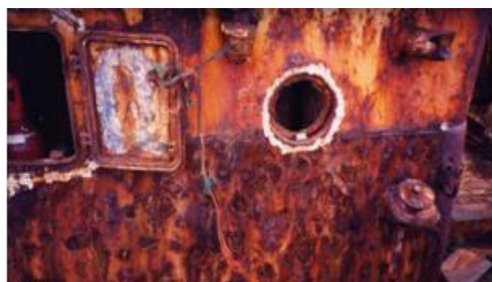
Slika 3. Uvećani prikaz lokalizirane korozije [8]
