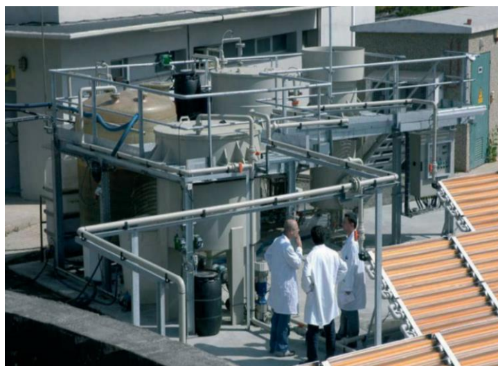
Slika 6. Oprema za biološku obradu otpadne vode pri Fentonovoj oksidaciji. [8]
