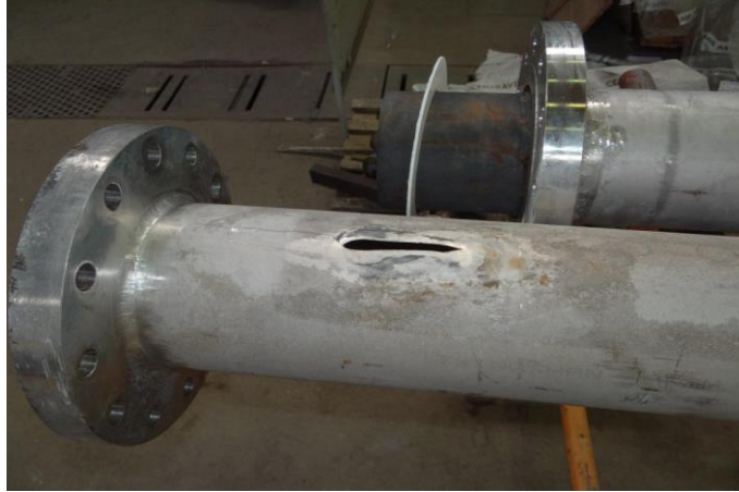
Slika 24. Korozijsko oštećenje plašta reaktora
