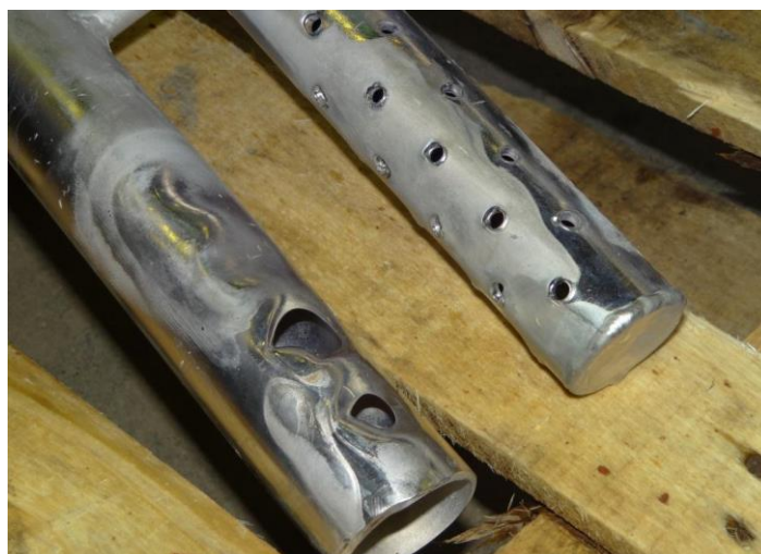
Slika 23. Korozijsko oštećenje vrhova cijevi
