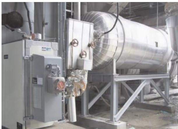
Slika 11. Jedinica za uklanjanje dušikovih oksida na postrojenju DUKI 1
