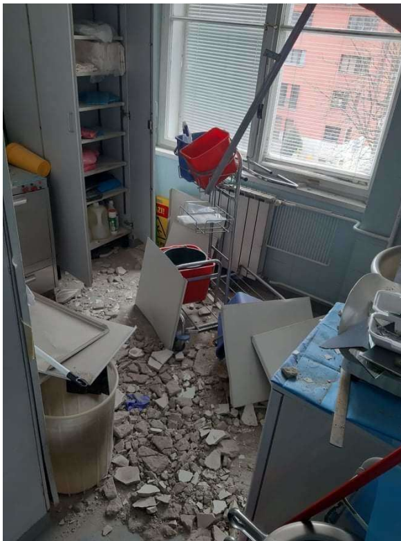
Slika 21. Stanje bolnice u Petrovoj ulici nakon potresa [30]
