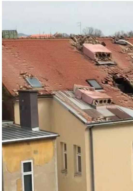
Slika 26. Primjer štete nastale urušavanjem dimnjaka [38]
