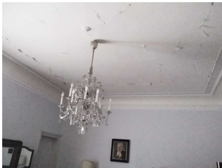
Slika 31. Oštećenja stropa u palači Pongratz [40]
