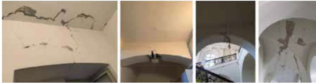
Slika 30. Pukotine na nadvratnicima i svodovima [28]
