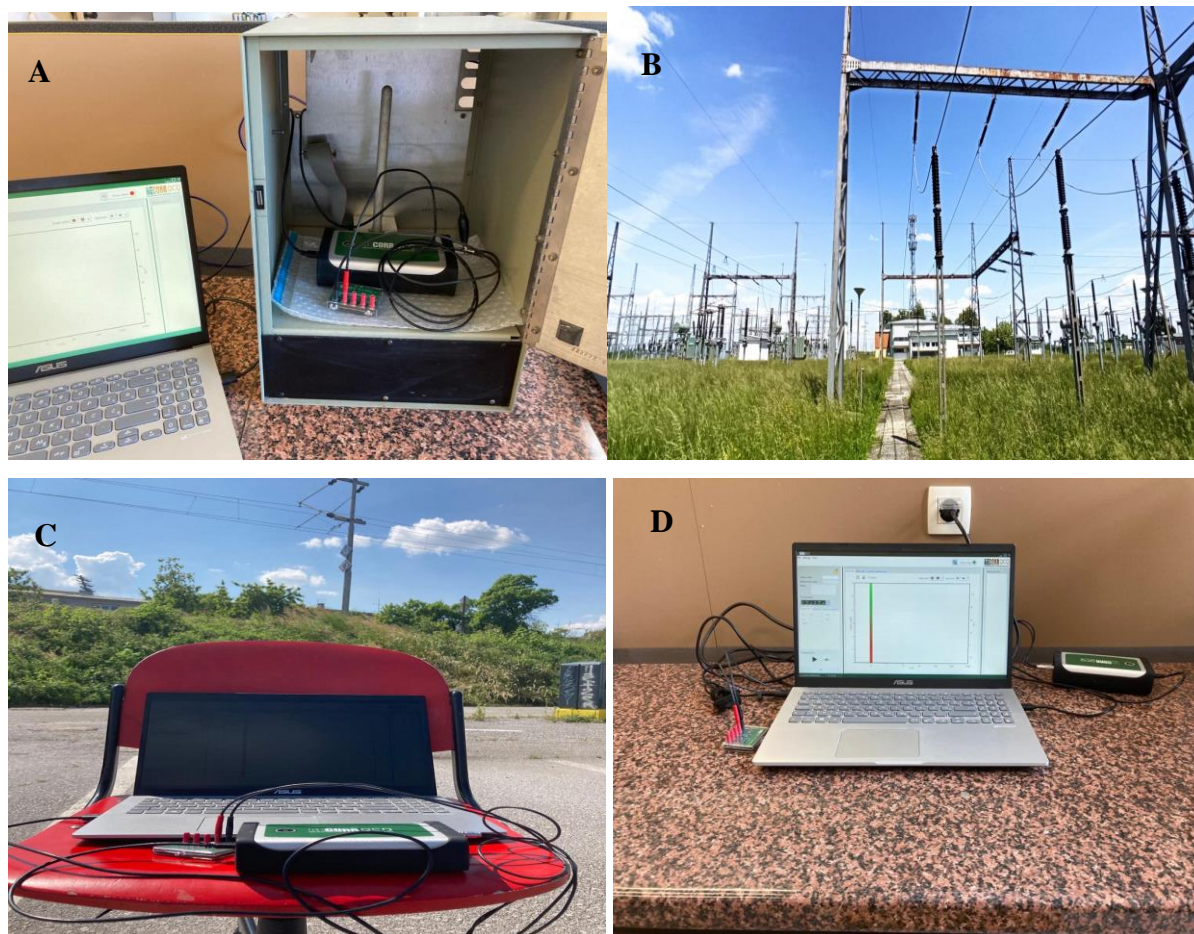
Slika 16. Prikaz uvjeta provedbe ispitivanja: A) Faradayev kavez, B) trafostanica, C) pored željeznice i D) laboratorij.
