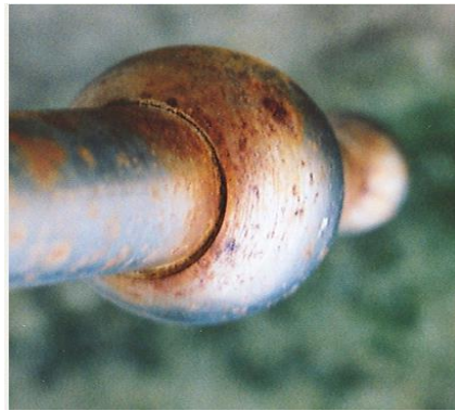
Slika 2. Korozija na cijevima [10]
