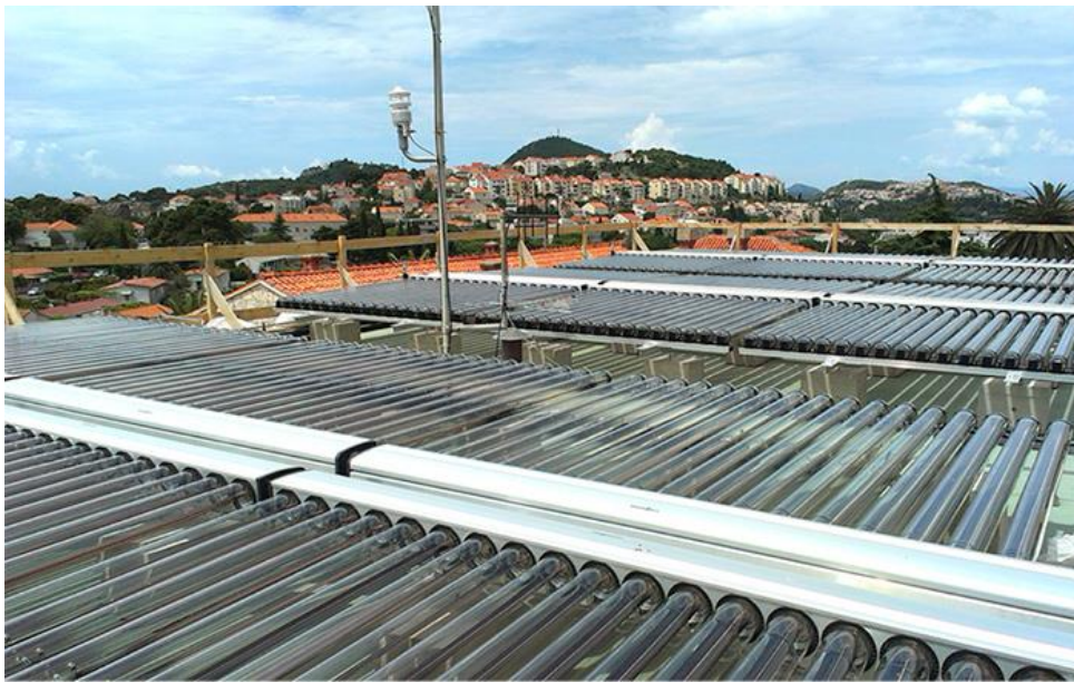
Slika 9. Polje solarnih vakuumskih kolektora na krovu objekta [16]
