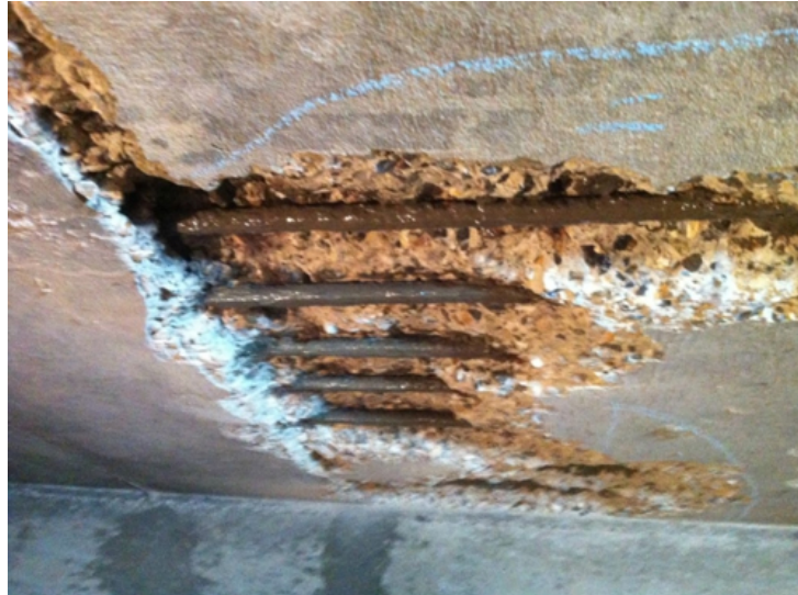
Slika 3: Prikaz korozije u armiranom betonu 7
