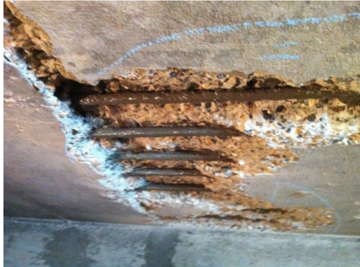
Slika 3: Prikaz korozije u armiranom betonu 7
