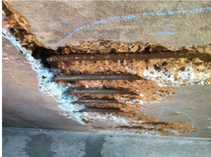
Slika 3: Prikaz korozije u armiranom betonu 7
