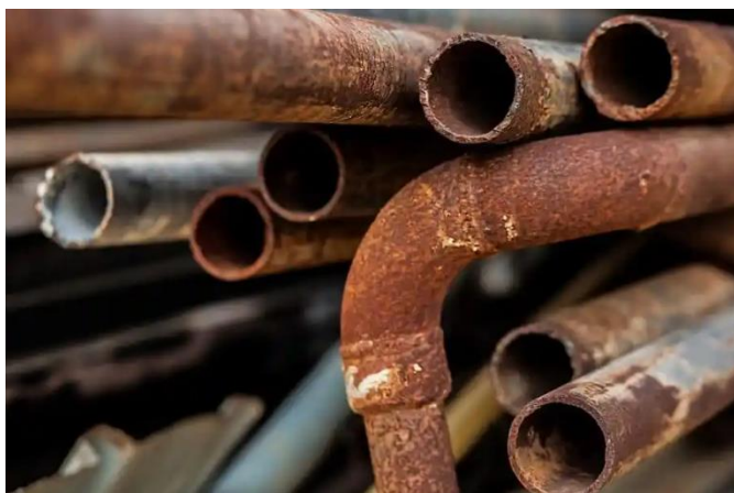
Slika 3. Prikaz površine korodiranog metala. 9
