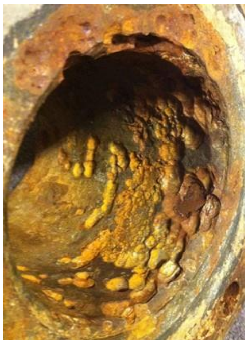
Slika 5. Primjer korozije cijevi pod mikrobiološkim utjecajem[14]
