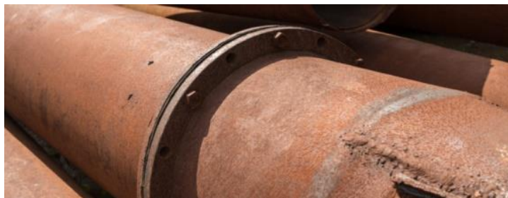
Slika 1. Primjer jednolike korozije cijevi[10]
