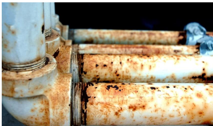
Slika 4. Primjer pukotinske korozije cijevi[8]
