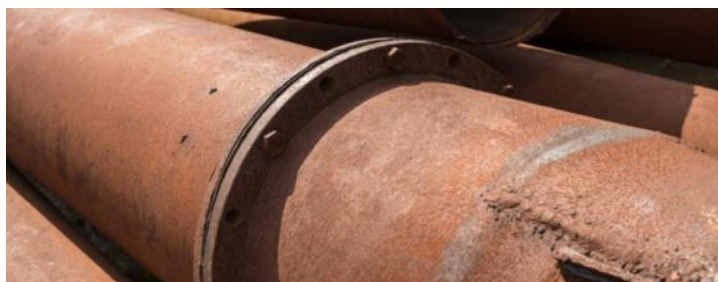
Slika 1. Primjer jednolike korozije cijevi[10]
