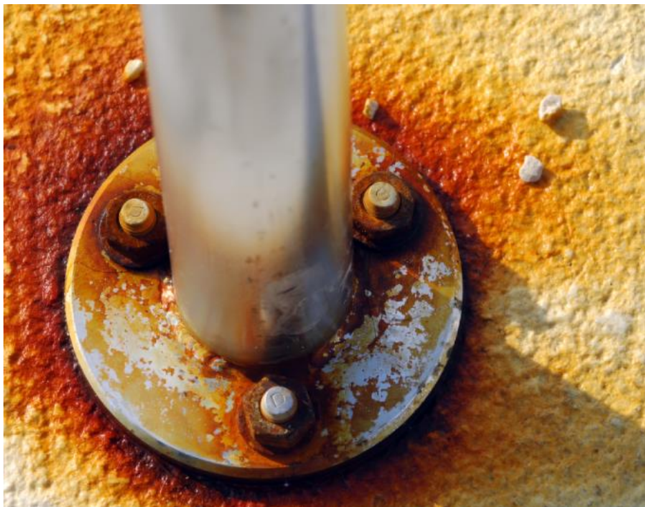
Slika 3. Primjer korozije na čeliku 10
